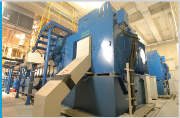
世界最高レベルの発電効率を誇る、フィンランドバルテラ社製ガスエンジンが、幕張地域冷暖房センターで稼働
